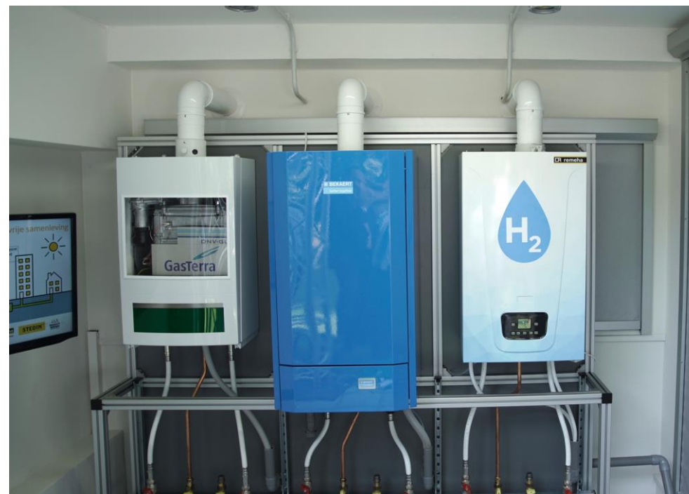
Voorbeeld proefproject 100% waterstofketels in appartement Rotterdam
