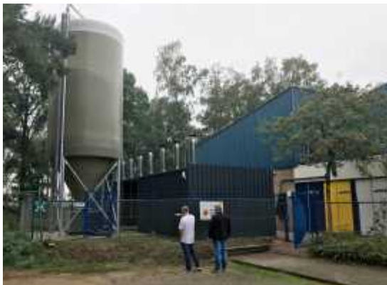
Pelletketels in cascade bij zwembad
